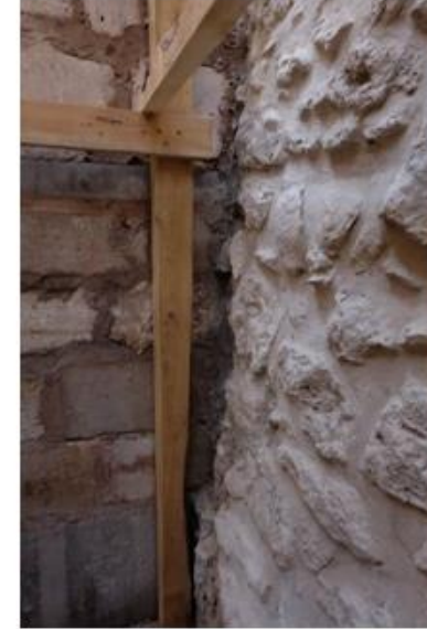
Çürütülüp yeniden oluşturulan dik duvar birleşimi
