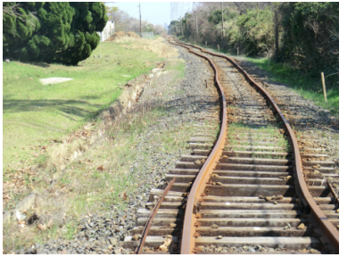
図 17 鹿島臨海鉄道（貨物線，神奈川市内）の被害
