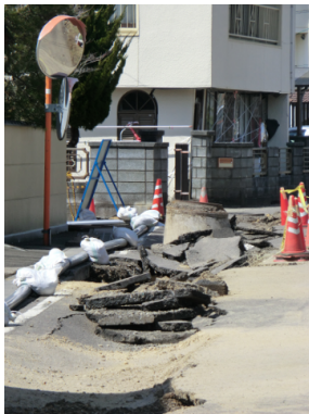
図 20 白河市内での埋設管の埋め戻し土の液状化による被害。奥の住家は大きく傾斜している。
