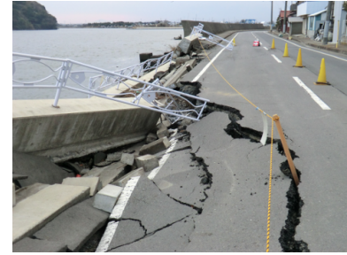
図 28 那珂川河口付近の護岸の崩壊
