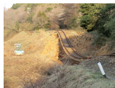
図16 鹿島臨海鉄道(北浦湖畔駅-大洋駅間)の盛土部の被害
