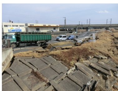
図15 江合橋左岸下流側の堤防盛土の被害
