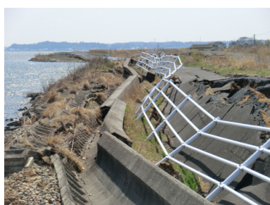
図14 堤体の液状化により沈下した堤防(洶沼川左岸 8.0k 付近。茨城県東茨城郡茨城町下石崎)
