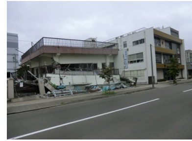
図 25 仙台市宮城野区における被害の例
