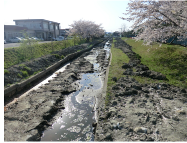
図 27 香取市佐原の河川の液状化による被害
