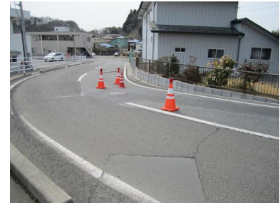
図 19 栗原市築館における被害の様子。
