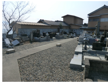
図 21 日立市内の海岸近くの墓地における墓石の転倒。海岸線に平行に並んでいる墓石はほとんどが転倒している。奥の住家の棟瓦が落下しているが、周囲の住家に大きな被害は見られない。
