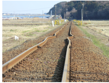
図 18 ひたちなか海浜鉄道湊線（金山駅-中根駅間）の線路変状
